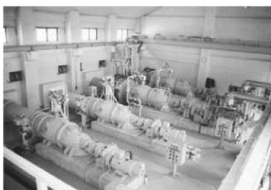
米袋揚水機場
