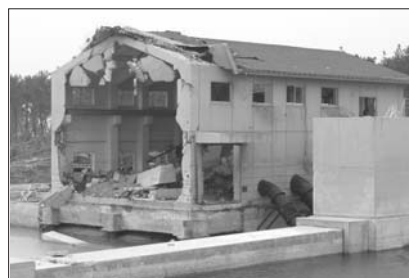
巨理町の花笠第2排水機場
